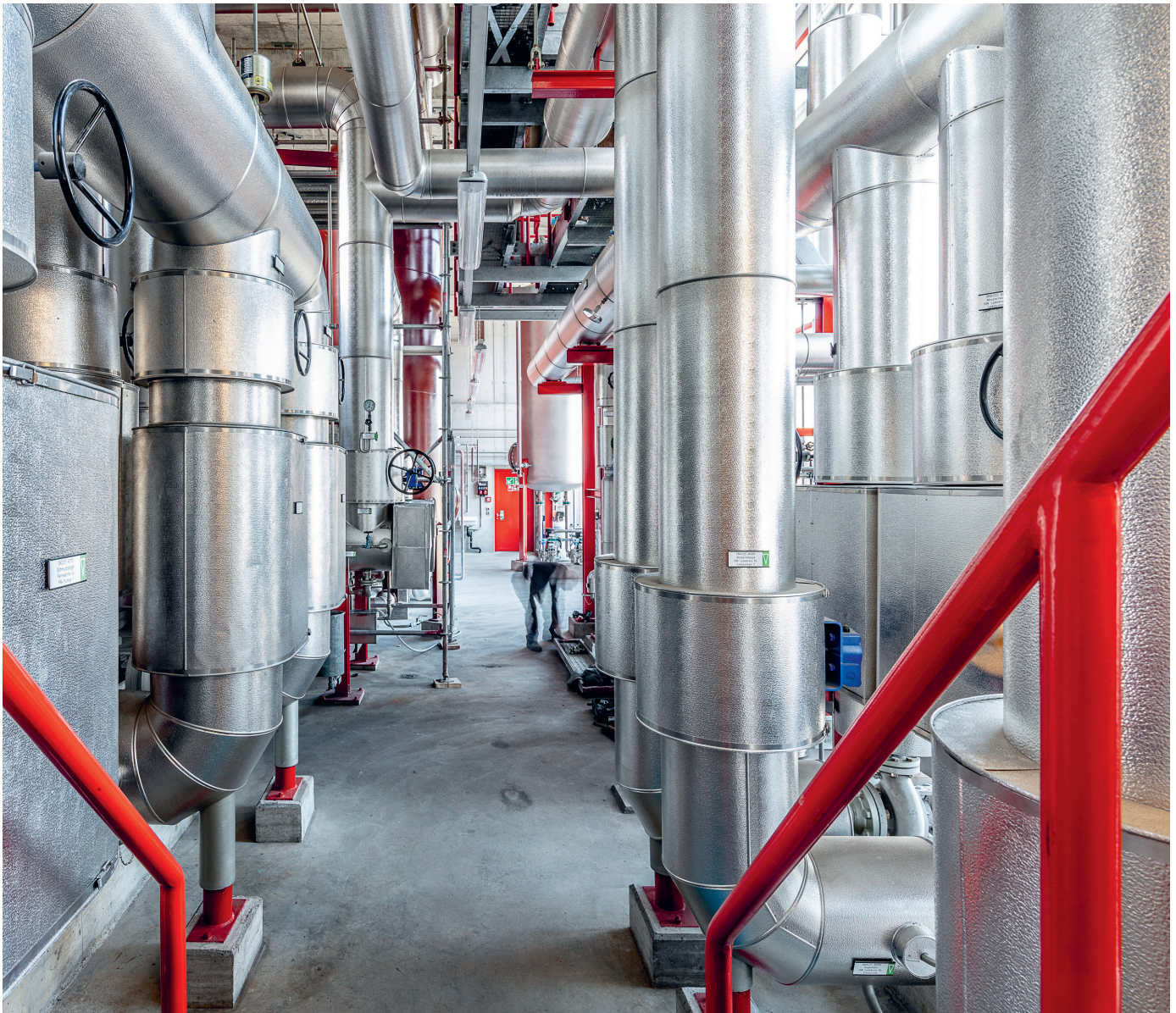
Das Innere der Fernwärmezentrale der GEVAG.
