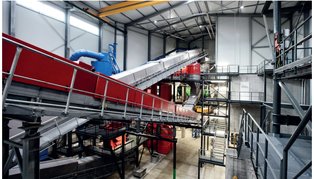
Staubdichte Förderanlage für die trockene Schlacke.
